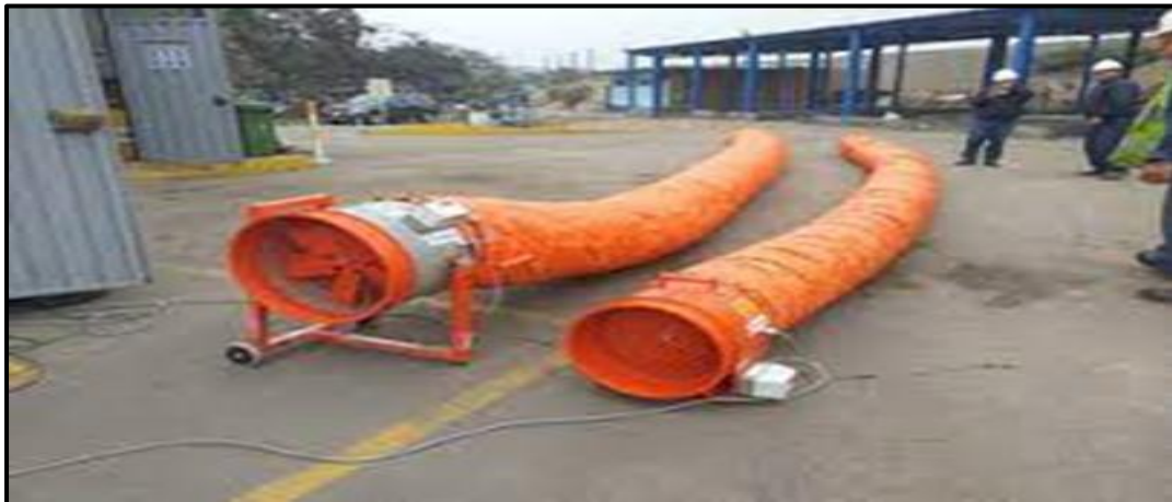
Figura 13: Manga de ventilación.
