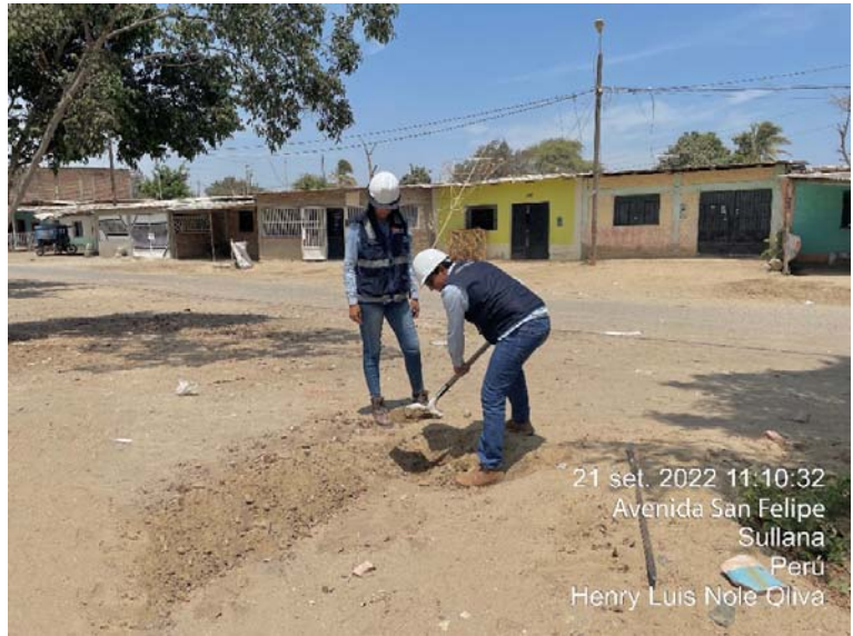
En la fotografía se observa el momento de excavación de la calicata C-2
