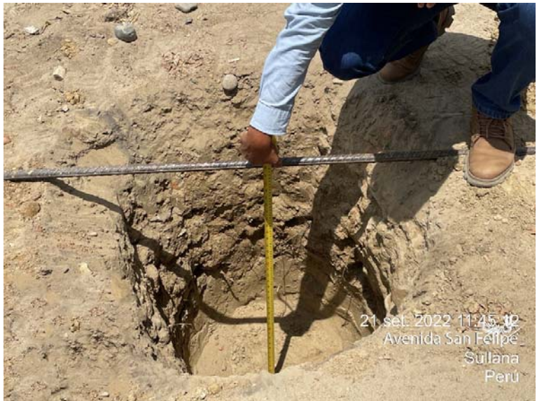
En la fotografía se observa la medida de profundidad de la calicata C-2
