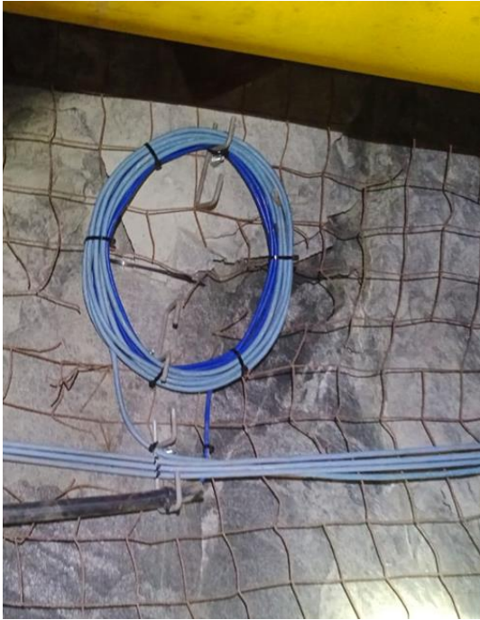
Figura 7. Cableado del sistema de monitoreo
