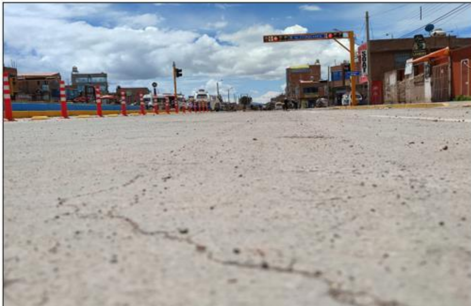
Fotografía 02. Fisuras que se encontró en la Av. Ferrocarril. Fuente. Elaboración Propia.
