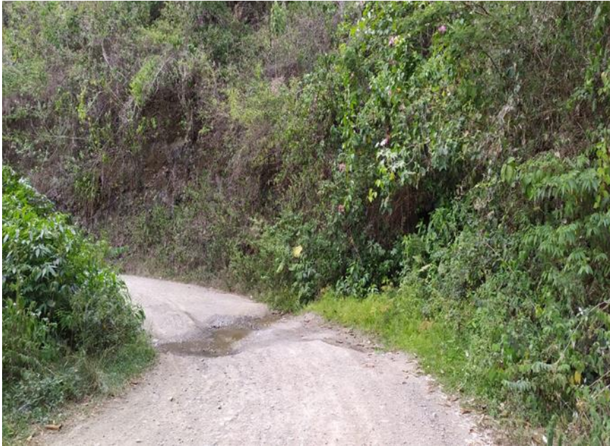
Figura: Presencia de cuse de agua
