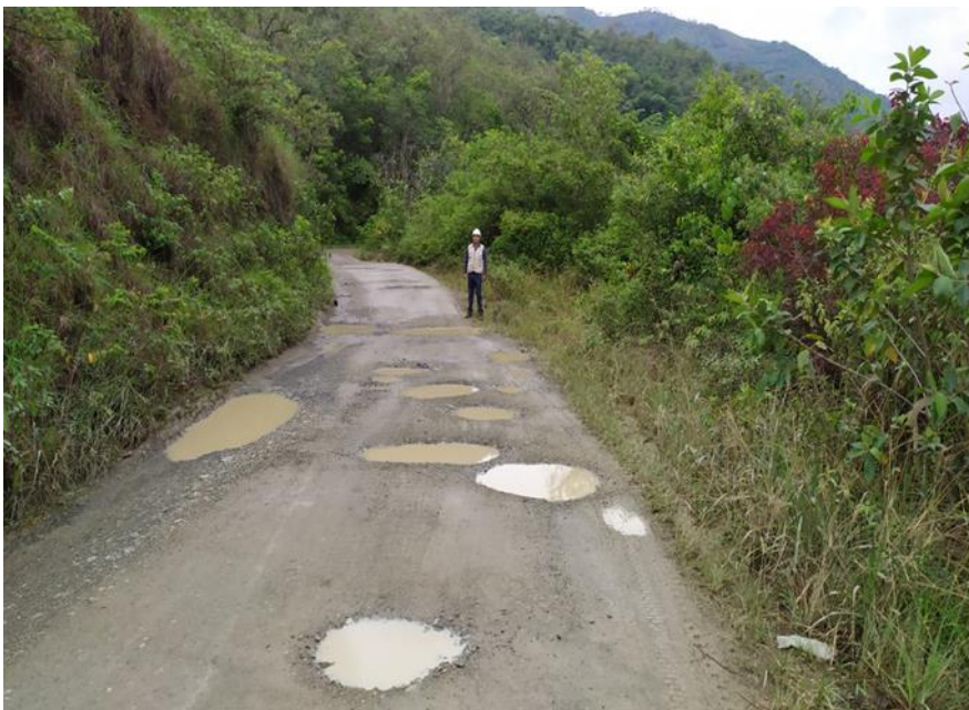
Figura: Baches debido a las intensas lluvias en la zona
