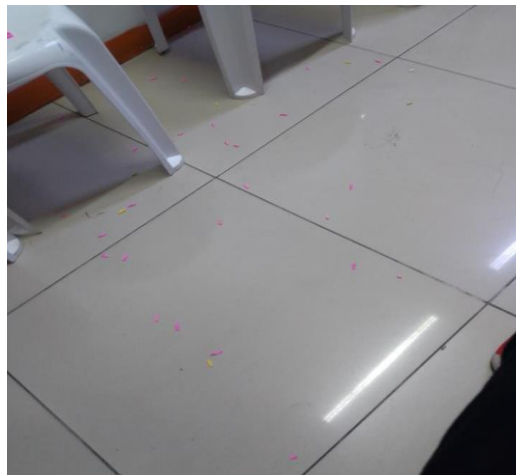
Figura 24. Piso antes de la limpieza
