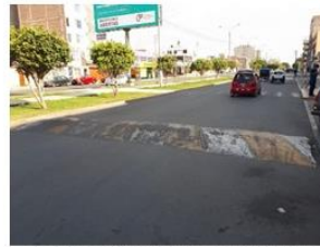
DETERIORO SEÑALIZACION EN ROMPEMUELLE
