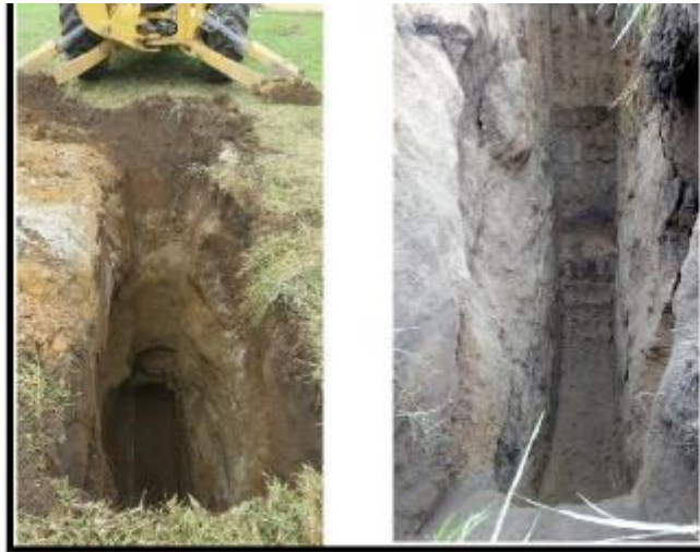
Calicata N°02 , Posterior lado derecho del hospital de apoyo Pichanaki. Profundidad a 7.00m, A 3.00m filtración de agua.
