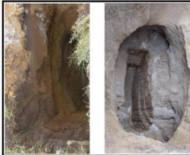
Calicata N°02 , Posterior lado derecho del hospital de apoyo Pichanaki. Profundidad a 7.00m, A 3.00m filtración de agua.
