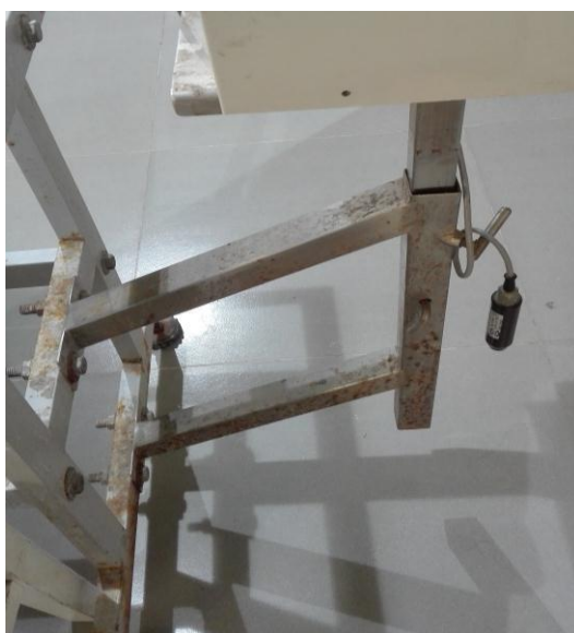
Figura 7. Condición de los equipos por falta de mantenimiento preventivo. Bazalar, febrero, 2016.
