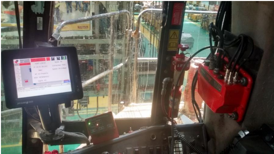
Instalación de Hub UHP del sistema de control de flotas Leica Geosystems de alta precisión y pantalla en el interior de la cabina de un cargador.
