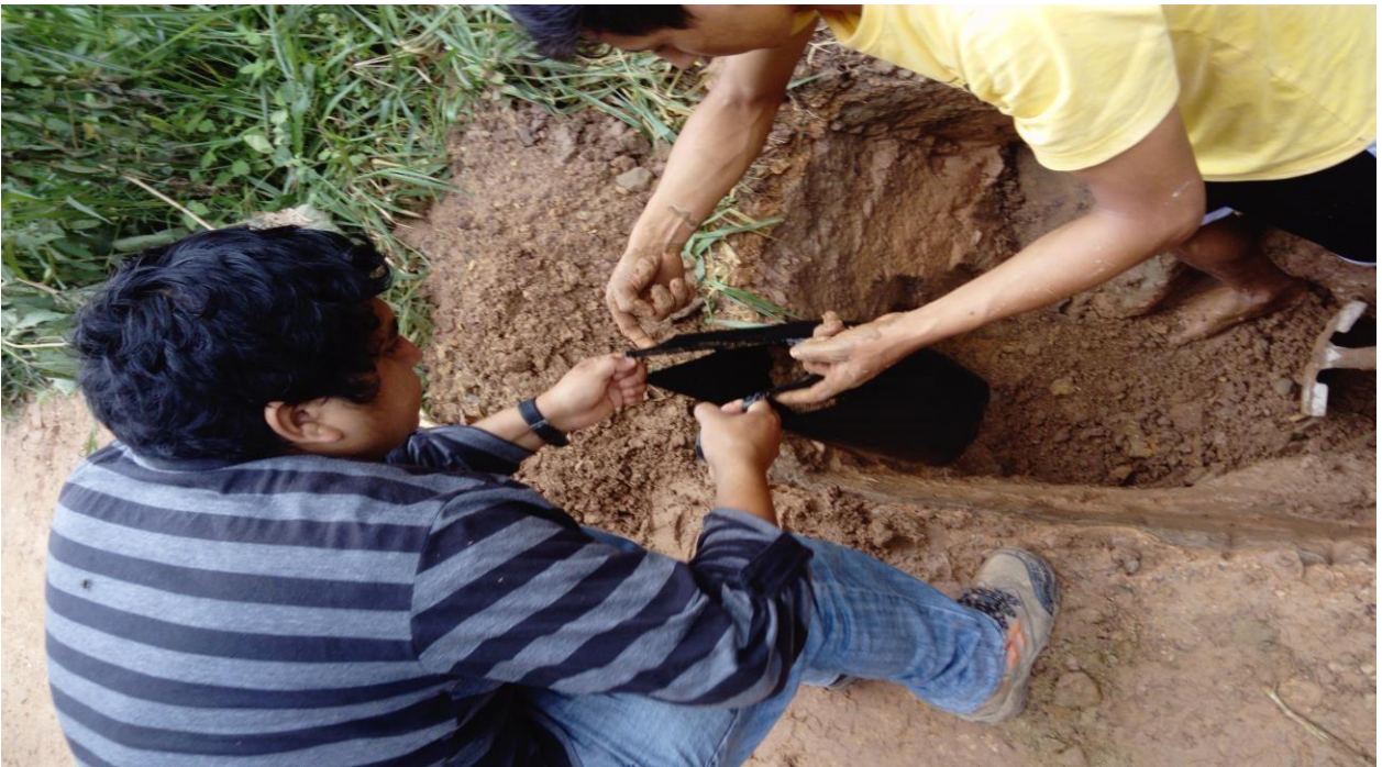
FOTO N° 03: realizando trabajos de extracción de muestras de calicatas para realizar los ensayos correspondientes.
