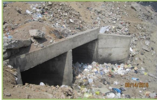
Figura N°77: Alcantarilla en Vía de Evitamiento.
