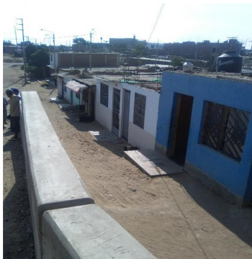
Figura N°54: Avenida 2 con cajas de saneamiento.
