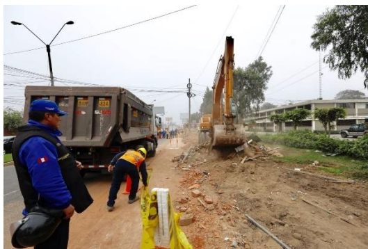
Figura N°126: Afectación del suelo por limpieza de terreno.
