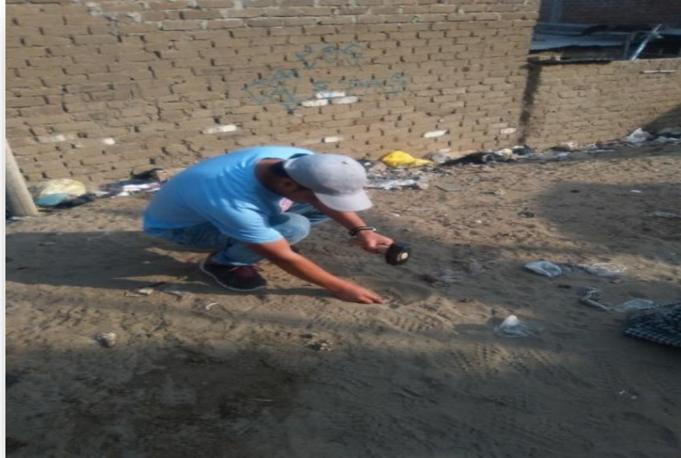
Foto N°137: Ubicando con estacas de madera las calicatas. Calicata N°1 en la Calle Los Laureles del Sector I.
