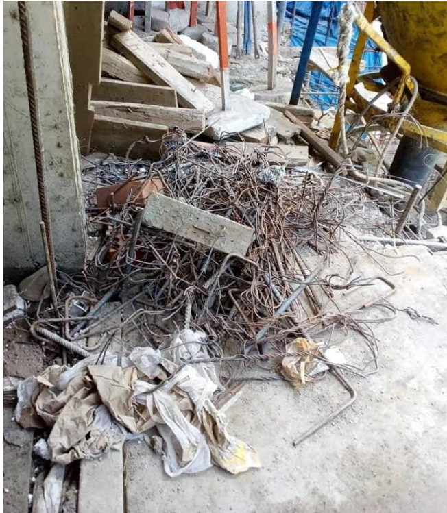
Figura 6. Desperdicio del Acero corrugado. Fuente: Elaboración propia.
