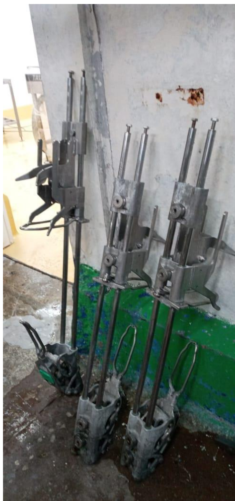
Figura 43. Unidades desmontadas para cambio de repuestos
