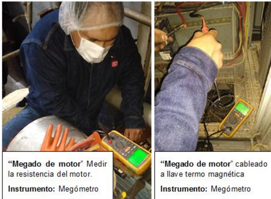
Figura 52. Megado de motor eléctrico
