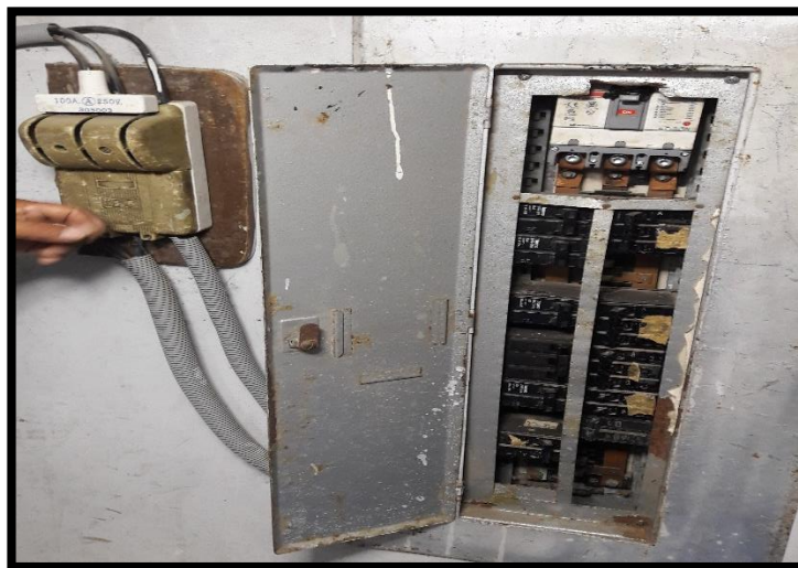
Fig. 25. Segundo tablero general del pabellón A.
