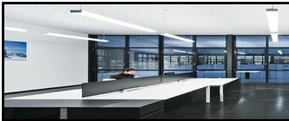
Fig. 5. Luminarias LED - Fuente: Ledbox
