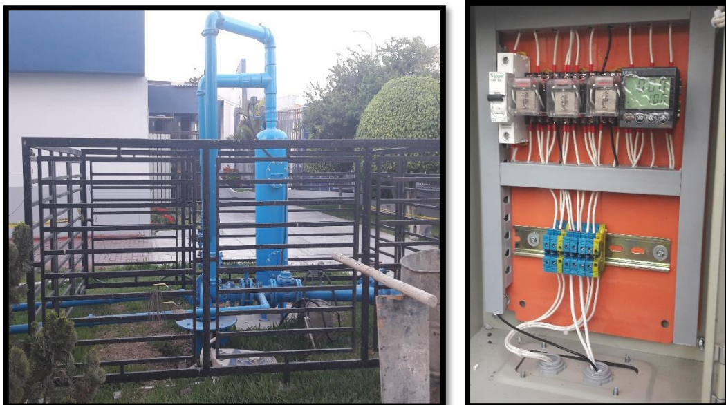
Fig. 31. Bomba sumergible con sus contactores e interruptor horario.
