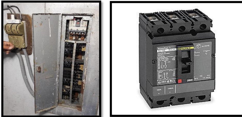
Fig. 33. Llave cuchilla del tablero, Interruptor Termomagnético de 150A.
