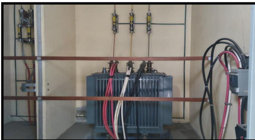
Fig. 2. Subestación eléctrica de la Universidad Cesar Vallejo
