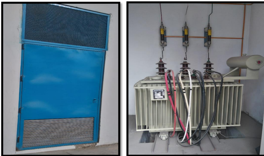
Fig. 20. Fachada e interior de la subestación SED-1
