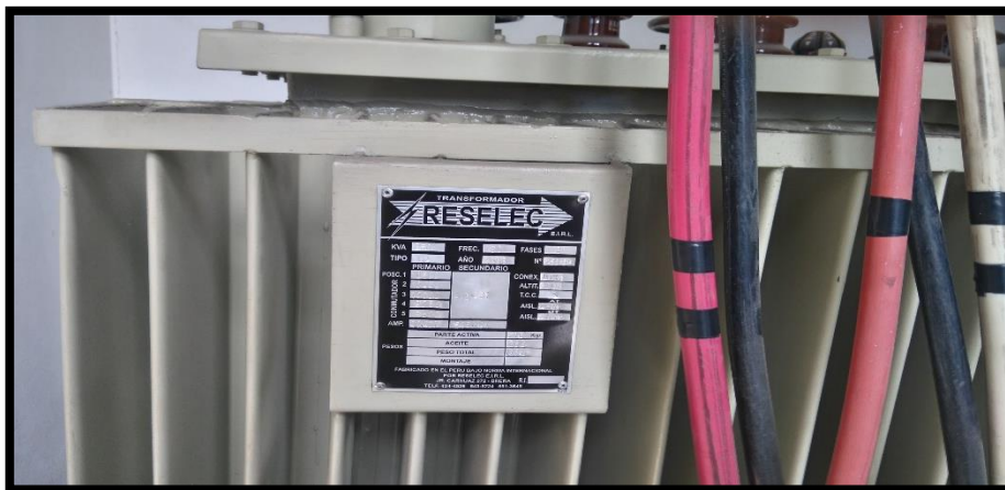
Fig. 34. Placa de características de transformador de distribución.
