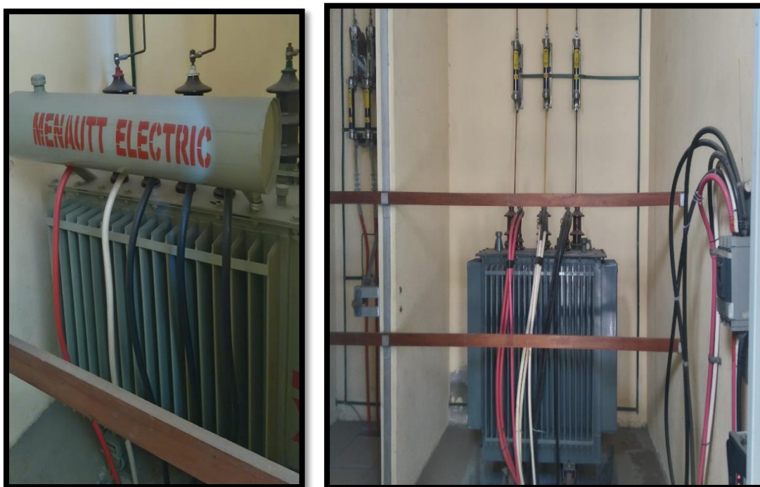
Fig. 21. Transformadores de la subestación SED-2
