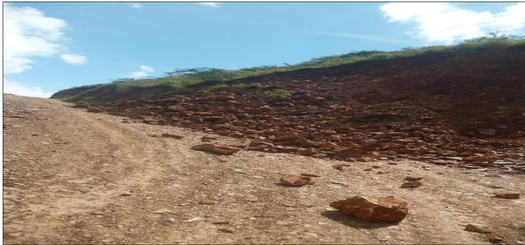
Derrumbes de taludes en la vía de acceso
