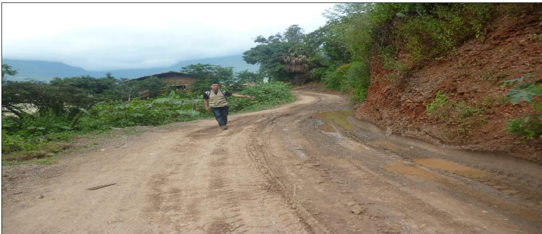
Presencia de humedad en la vía de acceso
