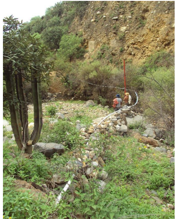
Se observa tubería expuesta en pase aéreo existente, sobre el río Huancay (Fuente: autor)
