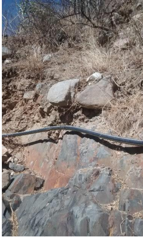
Tubería de línea de conducción expuesta a la intemperie.
