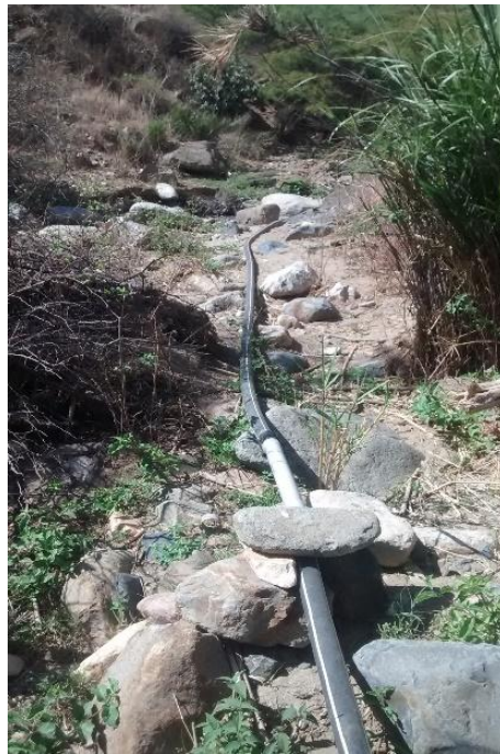
Tubería expuesta a la intemperie.
