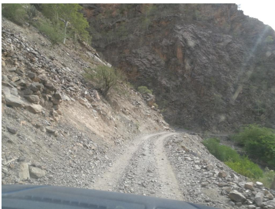
Fotografía 04: Talud inestable, deslizamiento de roca suelta
