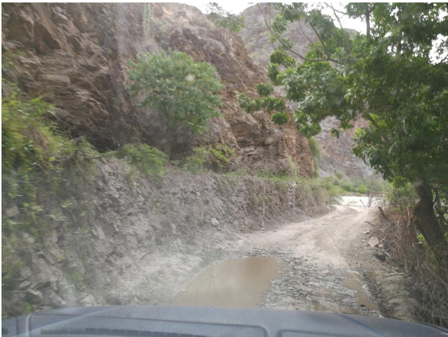
Fotografía 06: Aniego en la superficie de rodadura
