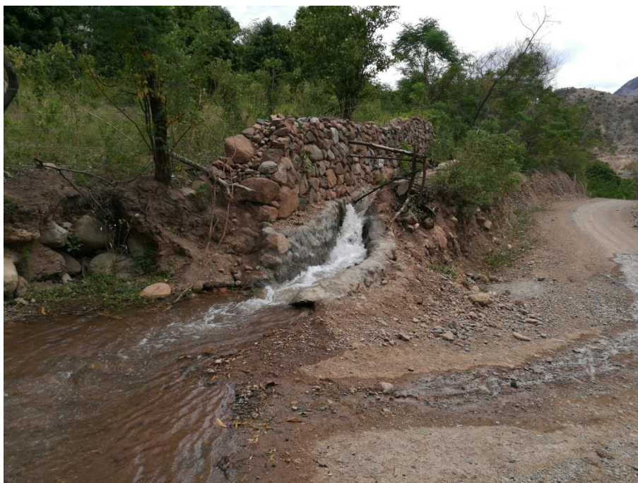
Fotografía 01: Inexistencia de Drenaje Transversal (Alcantarilla)
