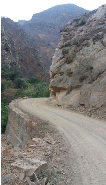
Fotografía 02: Inexistencia de dispositivos de señalización y elementos de seguridad
