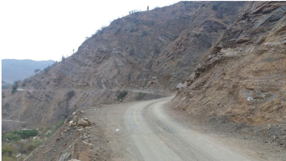
Fotografía 08: Radio de curva cerrado y sin señalización
