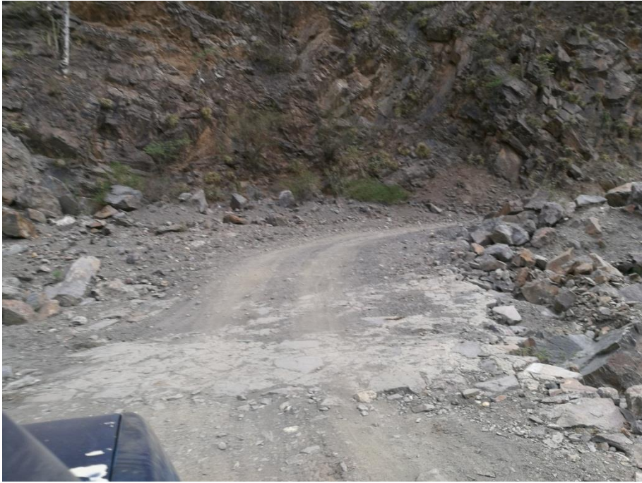
Fotografía 05: Sistema de drenaje (badén artesanal) en mal estado
