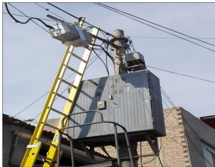
Figura 11. Instalación de armario telefónico de la empresa SERTES S.A.C
