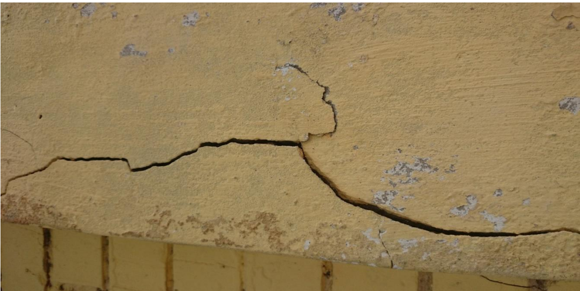
Anexo 12: Fisuras en la Viga por corrosión del Acero de Refuerzo – Callao 2017.
