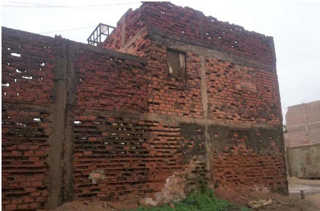
Figura 1: Estructuras de concreto armado corroídas por sales marinas – Callao 2017
