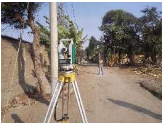
Figura 11: Se realizó el levantamiento topográfico de la red de alcantarillado tomando como puntos los niveles de buzones.
