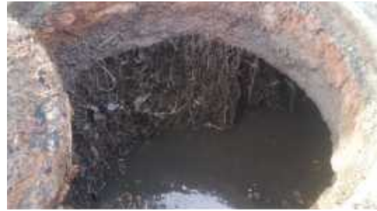
Figura 21: Se observó una gran presencia de raíces en el buzón N° 20, el cual se encuentra cerca de un árbol de Sauce, el mismo que tiene raíces profundas y ha colapsado el buzón.
