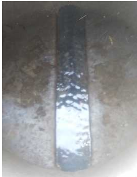
Figura 17: Se observan los bajos niveles de sedimentación presentados en los buzones.
