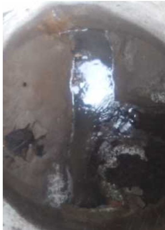
Figura 16: Se observan los altos niveles de sedimentación presentados en los buzones.
