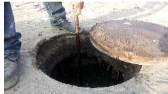
Figura 22: Se observa el colapso de los buzones en la red de empalme de la red de alcantarillado del asentamiento humano San Miguel con la red principal de aguas residuales del Distrito de Santa.
