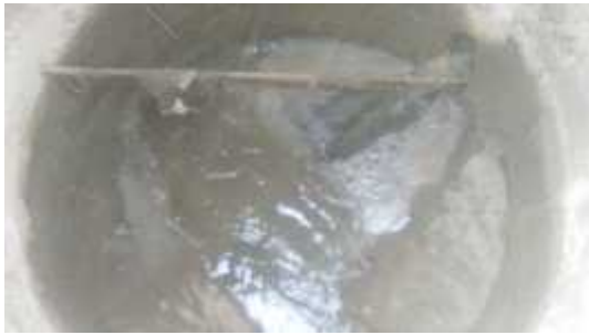
Figura 18: Se encontro una varilla de acero introducida en la tubería de red de alcantarillado, introducida posiblemente para desatorar parte de la red de alcantarillado.
