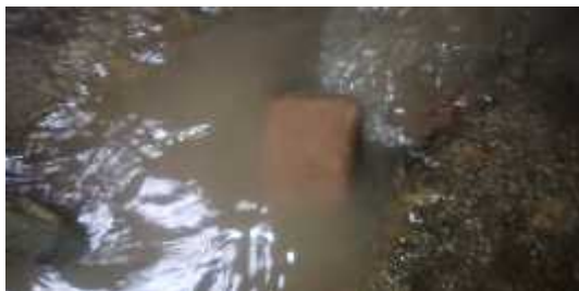
Figura 20: Se observó un ladrillo de construcción obstruyendo el paso de las aguas servidas el cual fue retirado para pesarlo.
