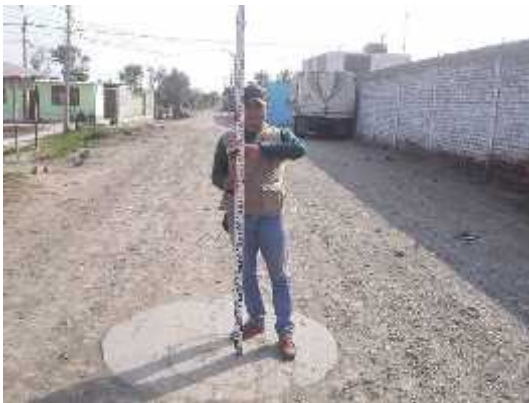
Figura 10: Se realizó el levantamiento topográfico de la red de alcantarillado tomando como puntos los niveles de buzones.
