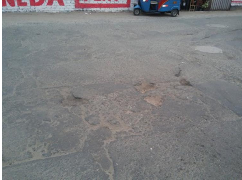
Figura 1: Grietas de contracción. Fuente: Elaboracion propia.
