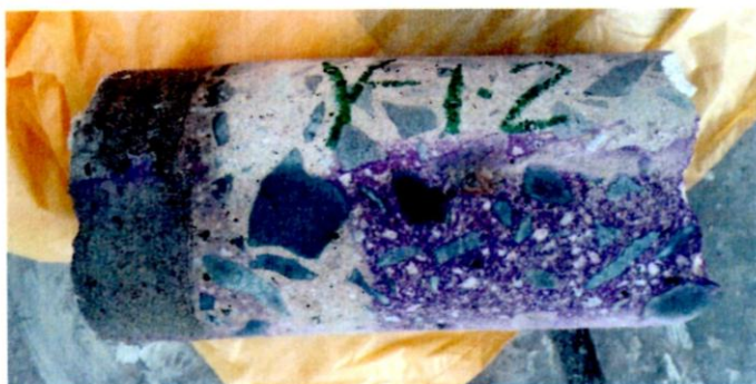
FOTO N°2: VIGA V 1 - 2 – PRIMER PISO – ENSAYO DE CARBONATACIÓN
