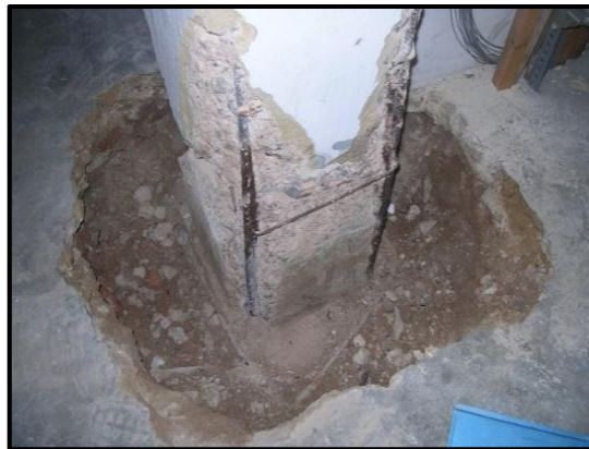
Figura 18: Columna dañada por carbonatación
