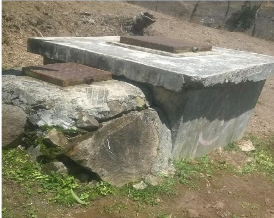
Foto 4: Cámara compresión existente
