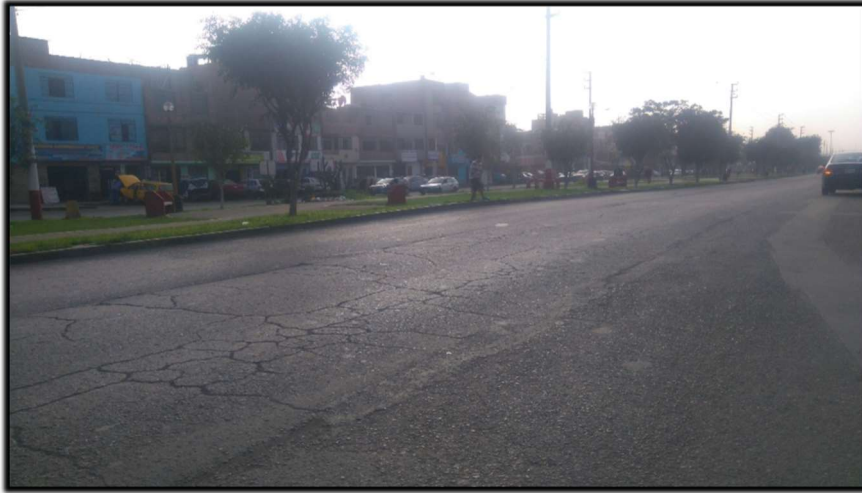
Figura 6: Se evidencia piel de cocodrilo en una de las calzadas.
