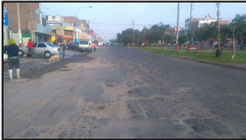
Figura 7: Desprendimiento de la carpeta de rodadura
