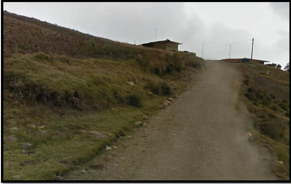
Figura 43. Estado actual de la carretera en donde se aprecia pendientes pronunciadas
