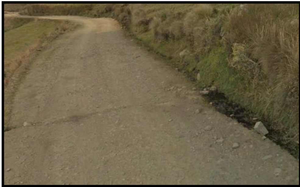
Figura 42. Estado actual de la carretera donde se aprecia la falta de obras de arte
