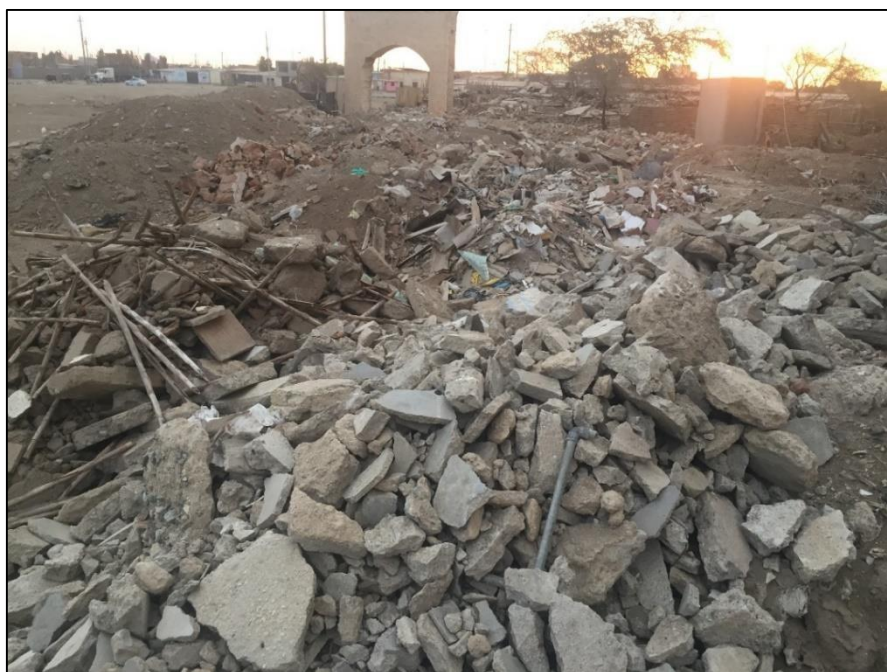
Figura 21. Zona identificada de acopio informal de RCD registrada como RCD_LAM_0024, con un volumen de 39908.00 m3.
