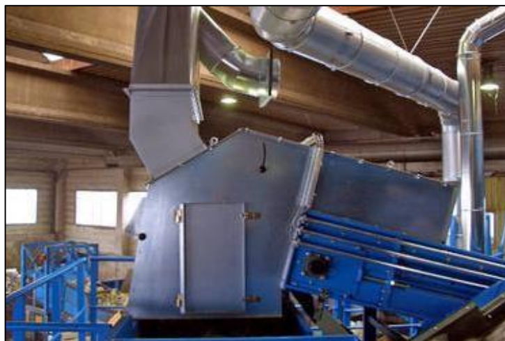
Figura 53. Sistema de aspiración.
