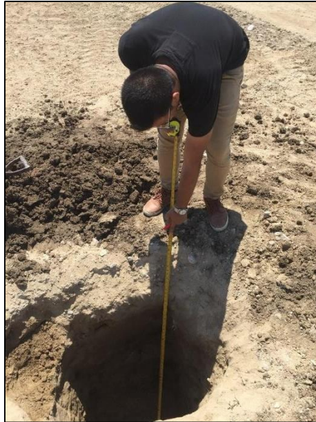
Figura 30. Verificando la profundidad de excavación, resultando ser 1.50m, en la cual se evidenciaron tres (03) tipos de estratos.
