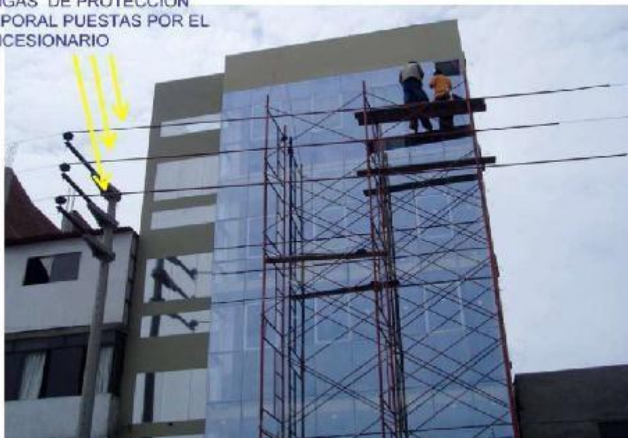
Figura 5 se muestra edificación incumpliendo las DMS con líneas coberturados, minimizando el riesgo para los trabajadores.
