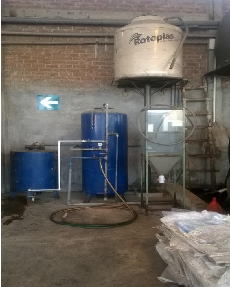
Ablandador de agua actualmente en mal estado.
