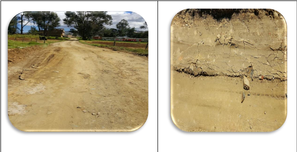
Figura 33. Estado actual del tramo de la carretera Pinar-Marian
