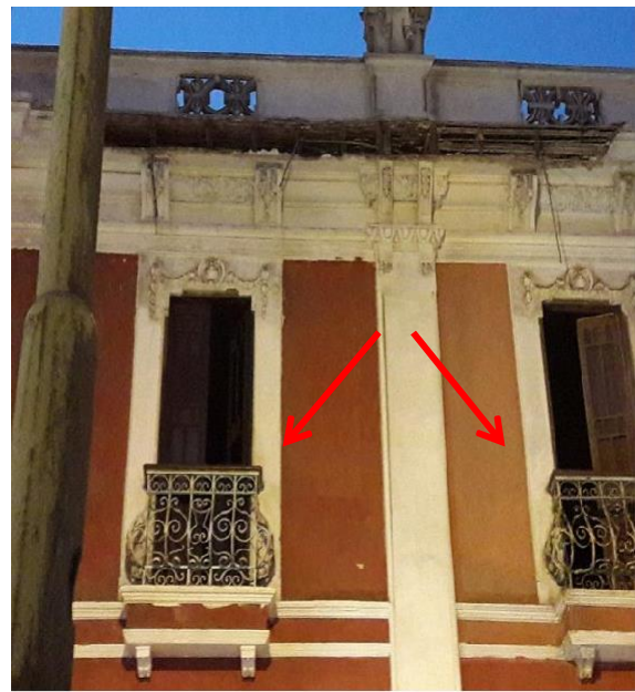
Los balcones presentan oxidación
