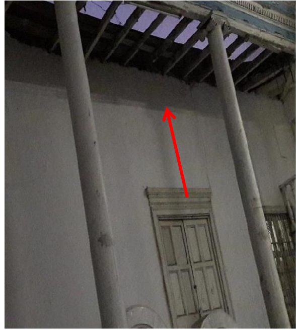
Gran parte del techo de la casona ha colapsado.
