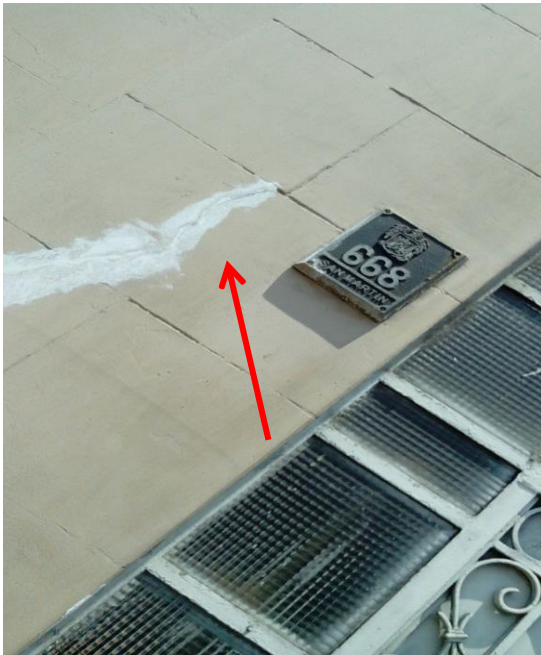
La casona presenta fisuras en los muros exteriores.
