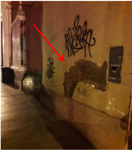
Los muros exteriores de la casona presentan escascaramiento.
