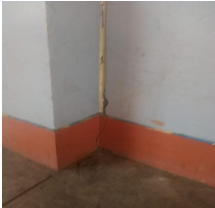
Anexo 09.8: fisura entre columna y muro.
