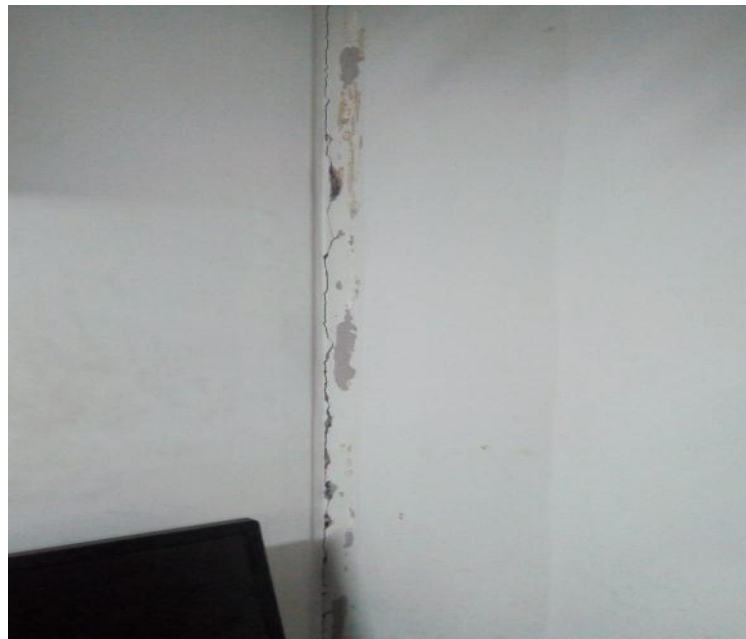
Anexo 09.6: Fisura en muro
