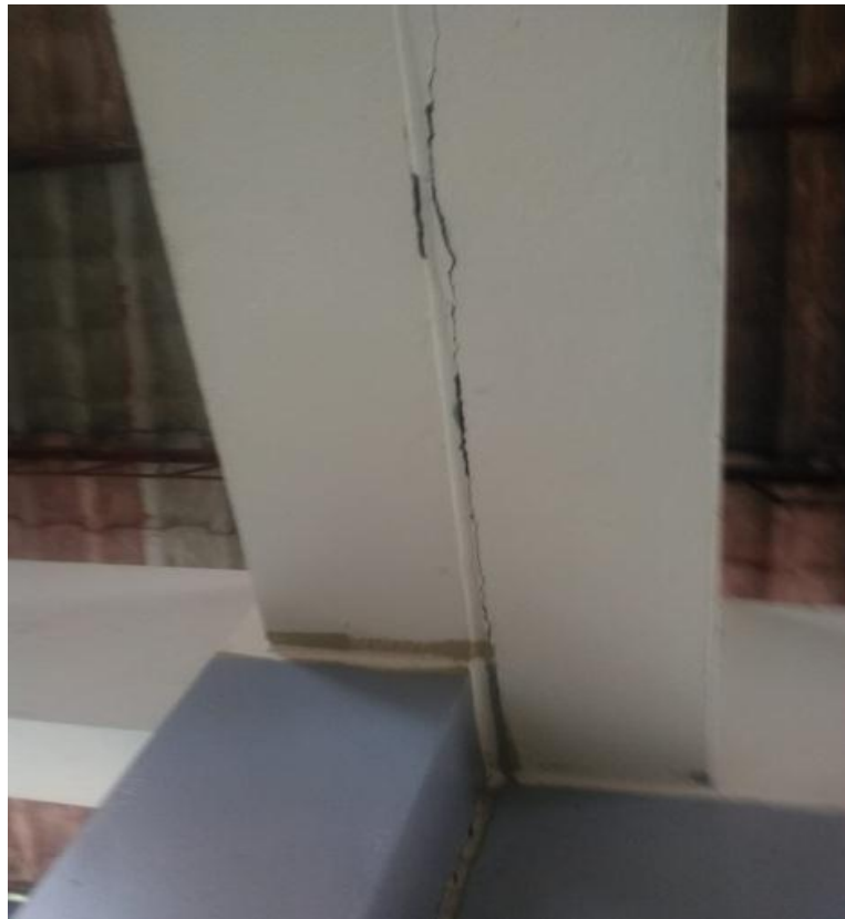
Anexo 09.1: Rajadura en viga.
