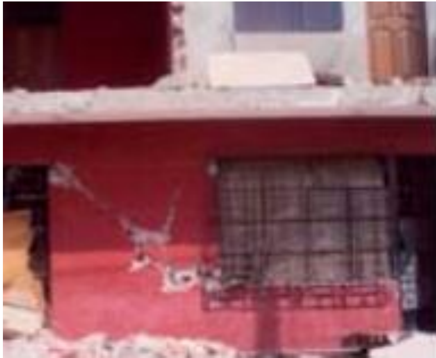
Figura 1.1: Falla por corte en muro
