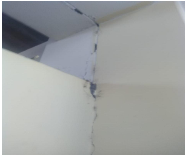
Anexo 09.3: Grietas en muro y viga.
