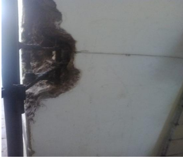
Anexo 09.7: losa con barras corroídas.
