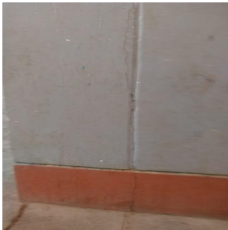
Anexo 09.4: Fisuras en muro.
