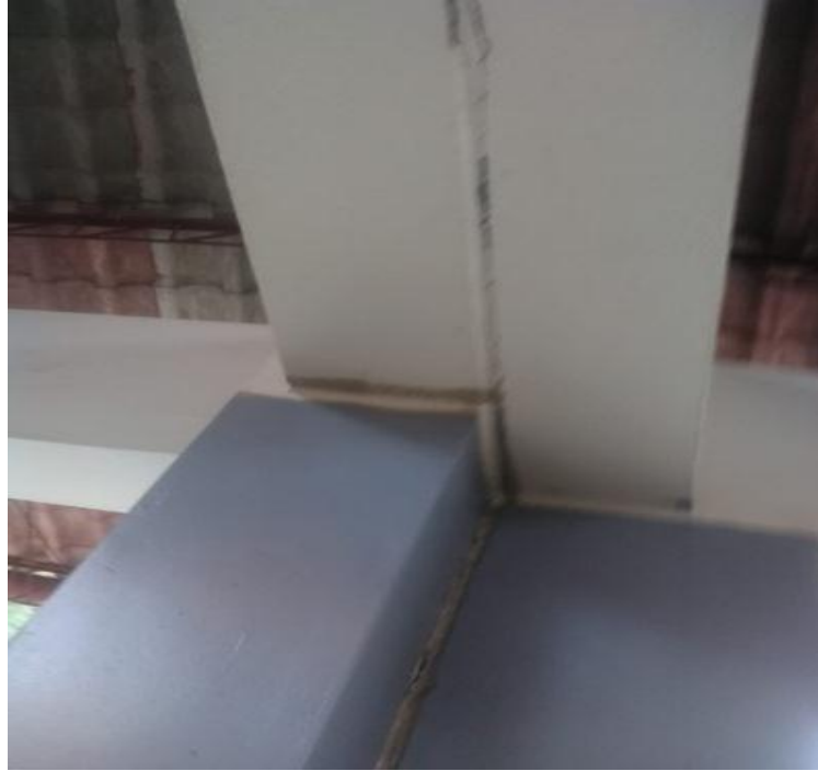
Anexo 09.5: Rajadura en junta sísmica entre columna y viga en edificación porticada.
