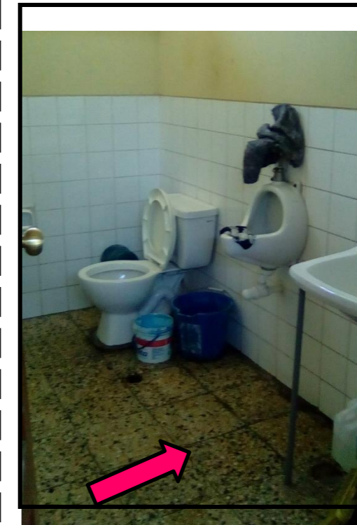
PISO DEL BAÑO: LOSETAS DESGASTADAS
