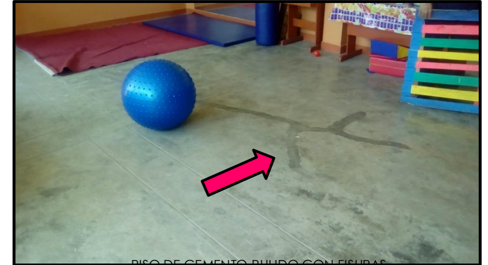
PISO DE CEMENTO PULIDO CON FISURAS
