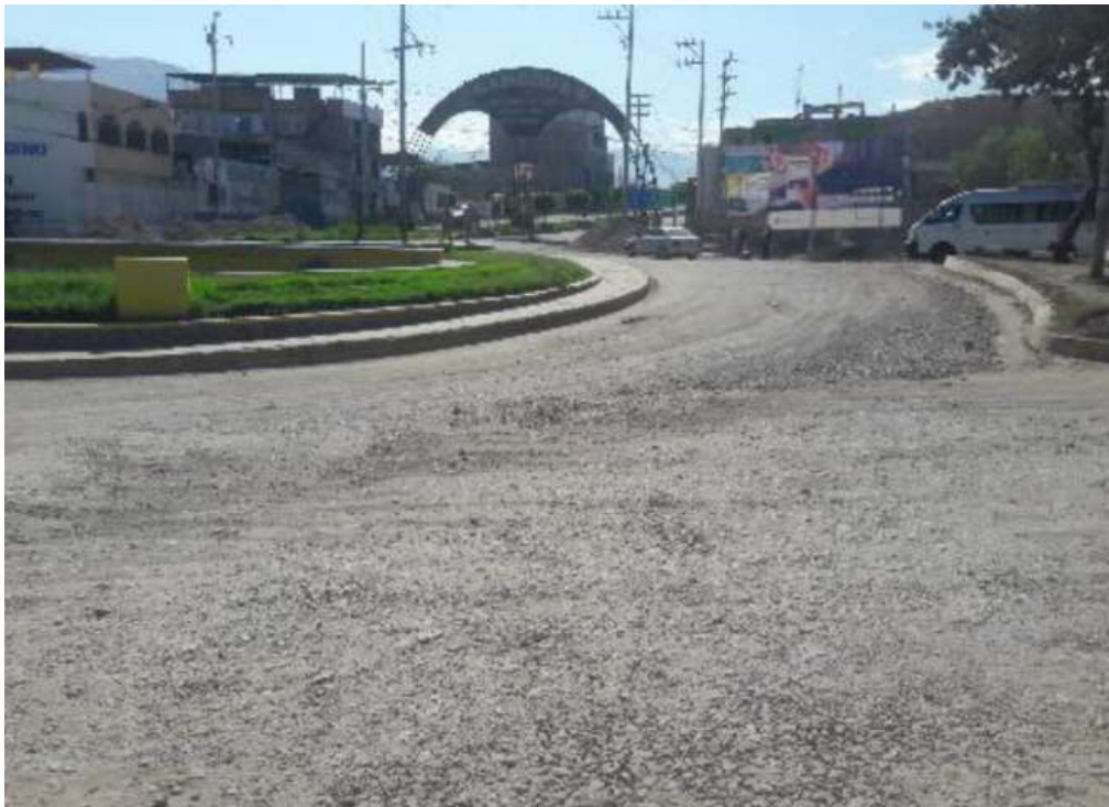
Figura N°05. Patologías – Pérdidas de la capa de rodadura
