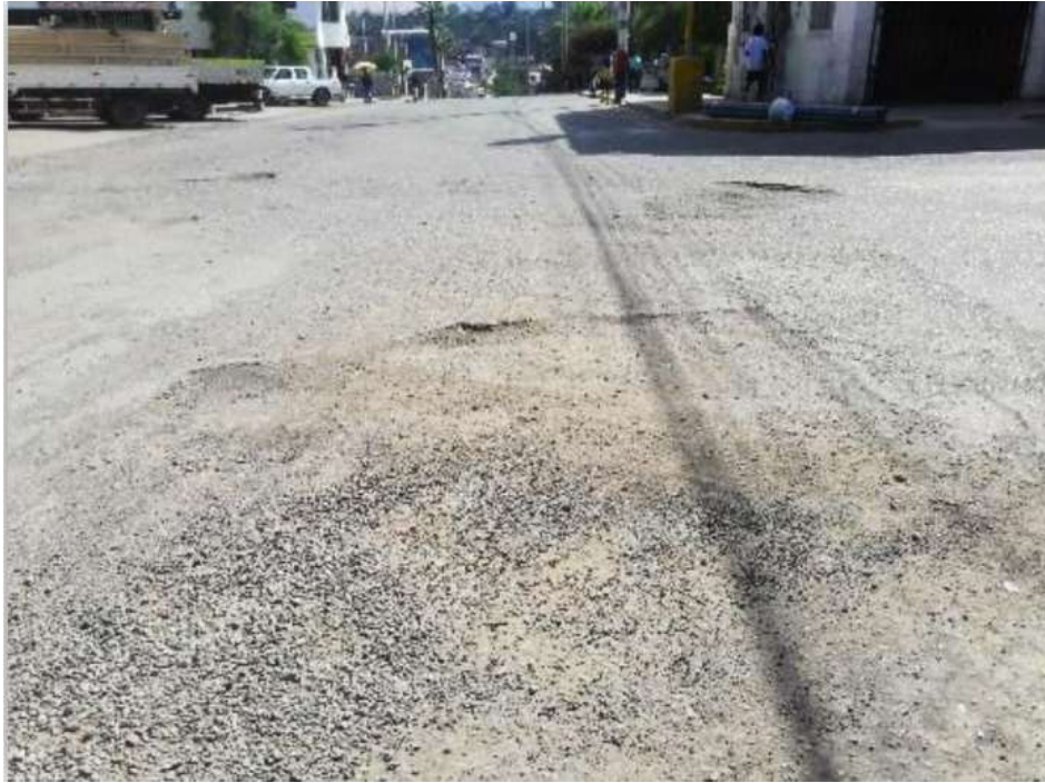
Figura N°04. Patologías – baches profundos
