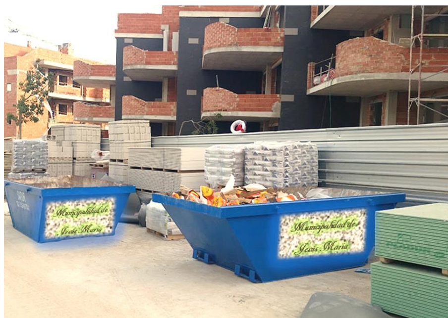
Figura 6. Contenedor de residuos sólidos
