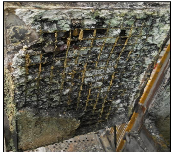
Figura 11. Caída de refractario Fuente: elaboración propia.
