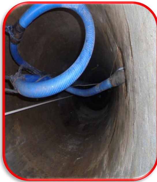
Figura N° 27: Pozo Tubular Existente
