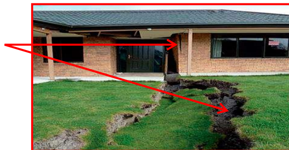
FIGURA N° 55 Vulnerabilidad alta: suelos
