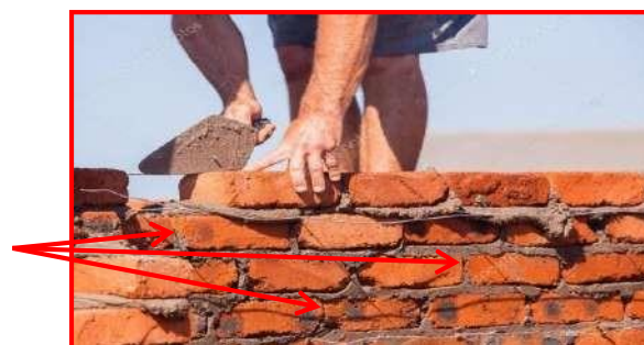
FIGURA N° 25 Calidad de las juntas de pega en mortero
