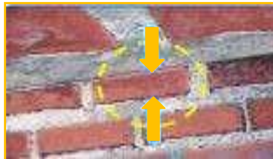
FIGURA N° 24 Calidad de las juntas de pega en mortero
