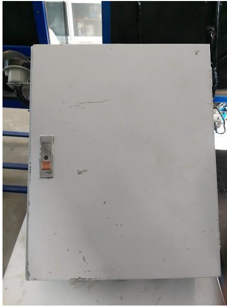
Fig 8. Tablero de distribución
