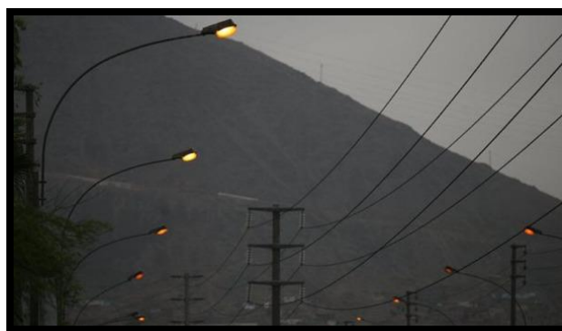
Figura 85: Imagen del alumbrado público (Fuente: Google)
