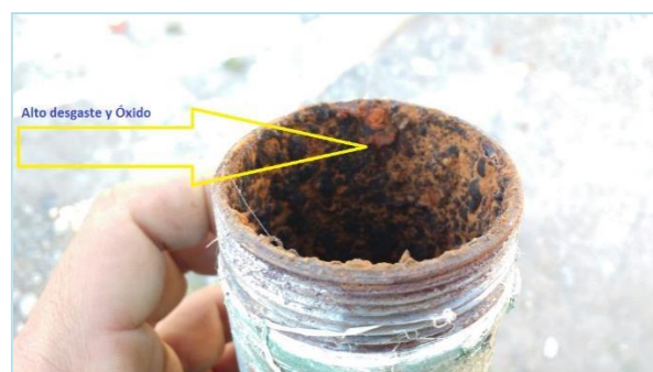
Figura 14 Óxido y Alto desgaste
