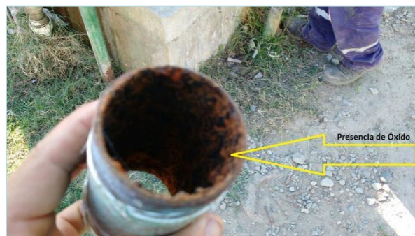
Figura 13 Óxido en tuberías
