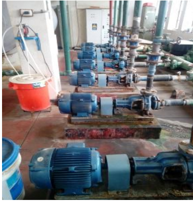
Figura 46: Bombas de agua Delcrosa Fuente: Hospital Regional
