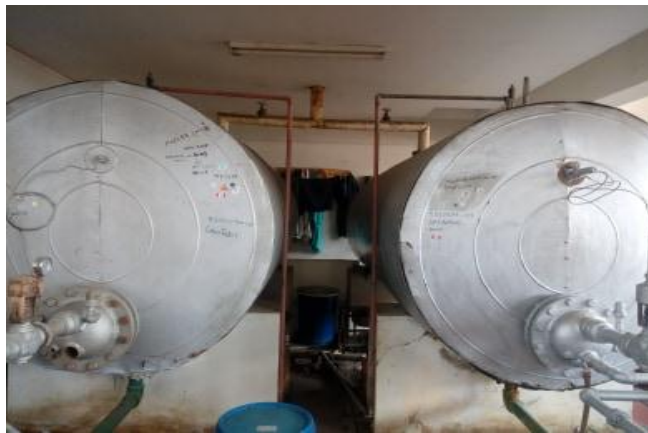
Figura 50: Calentador de agua Fuente: Hospital Regional
