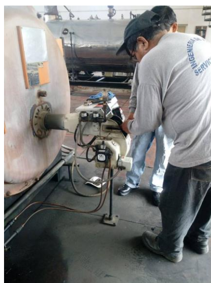
Figura 48: Mantenimiento del quemador Fuente: Hospital Regional
