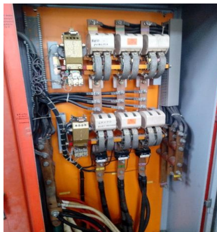
Figura 53:Tablero Eléctrico Fuente: Hospital Regional
