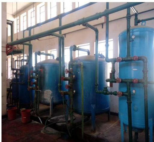
Figura 47: Tanque Ablandador Fuente: Hospital Regional
