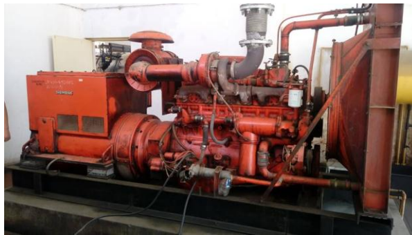
Figura 44: Grupo Electrónico Siemens Fuente: Hospital Regional
