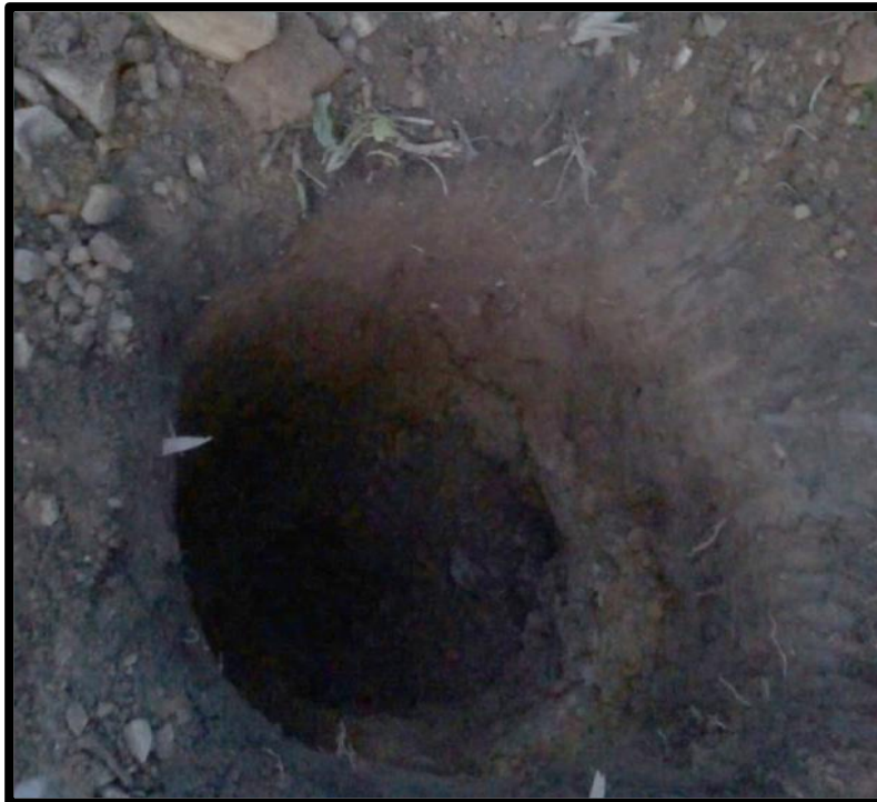
Figura 8: Se observa la calicata para poder extraer las muestras para estudios de mecánica de suelos.
