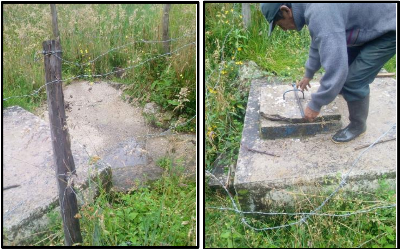
Figura 5: Se observa las condiciones actuales de las cámaras rompe presión tipo 7 de Higospamba, que se encuentran en mal estado y sin el cuidado adecuado.
