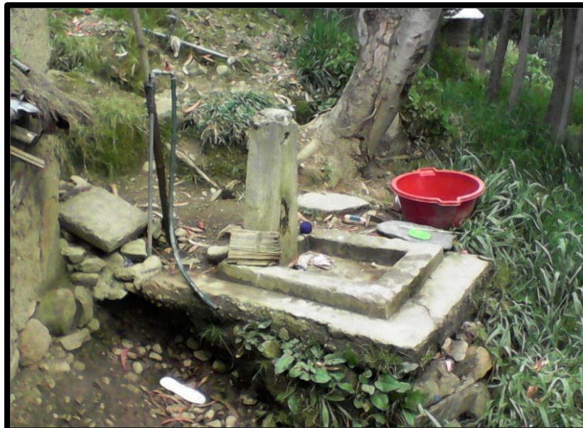
Figura 6: Se observa las condiciones actuales del sistema de agua potable Higospamba, que se encuentran en mal estado y no son los adecuados para poder vivir.
