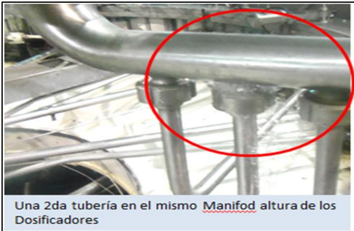
Figura 18: Tubería en Manifod
