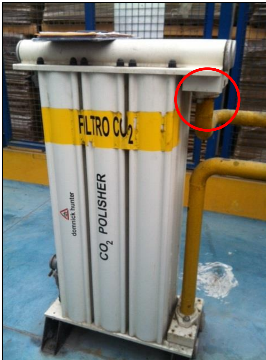
Figura 15: Reubicación de las Fugas de CO 2
