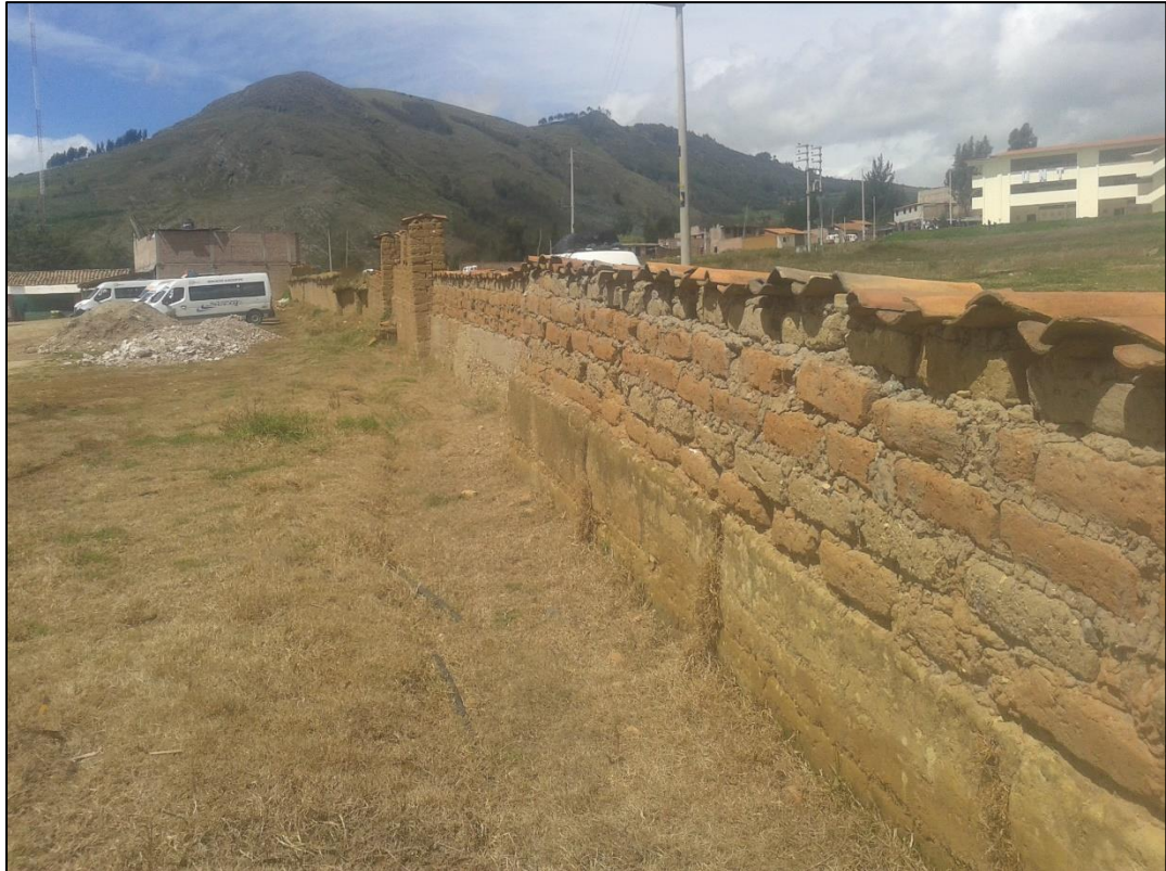
Figura 61. Cerco perimétrico, construido con sistemas constructivos vernaculares, el tapial y el adobe, debido a precipitaciones fluviales y climáticas, se encuentra en proceso de deterioro.
