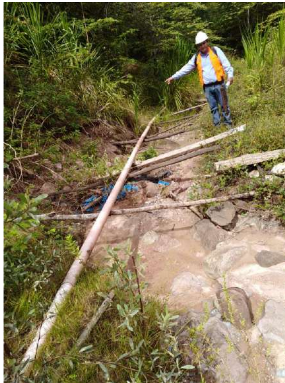
Fotografía 4. Red de tuberías de conducción, construido de manera empírica
