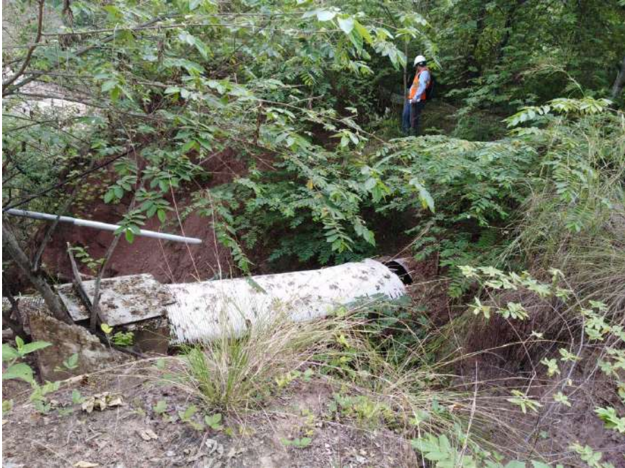
Fotografía 7. Vista detallada de tuberías de conducción en estado estructural de colapso
