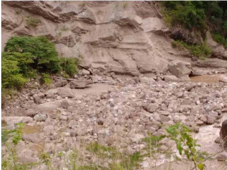
Fotografía 6. Vista panorámica de tuberías de conducción en estado estructural de colapso
