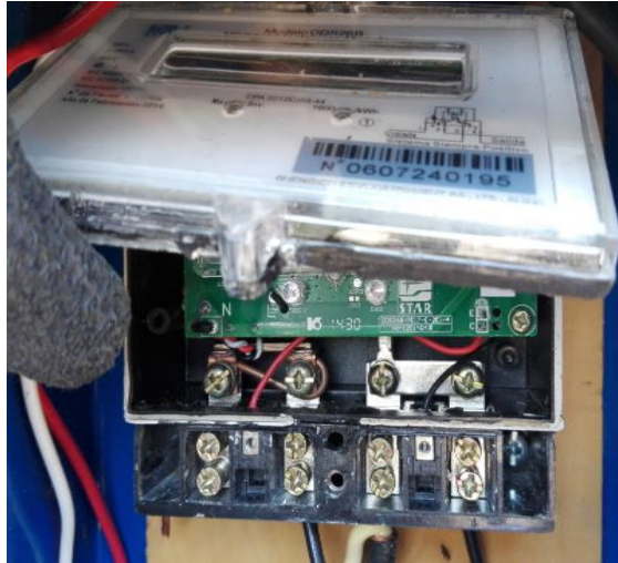
Figura 7. Puente interno en bornera de medidor monofásico
