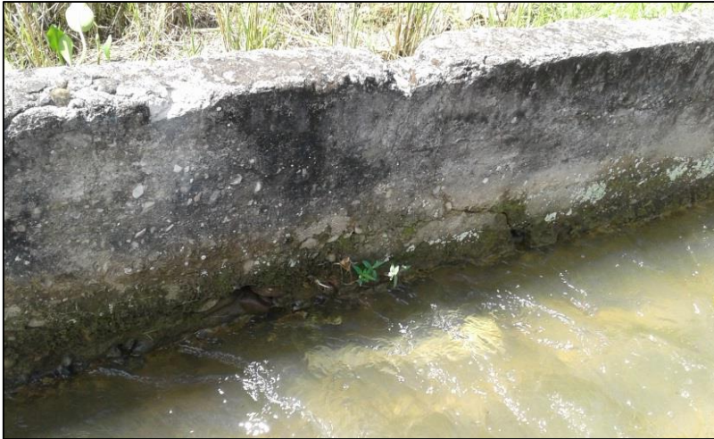
Fotografía 5. Estado crítico del canal progresiva 03+084 – 03+104
