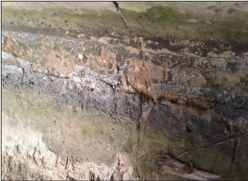
Fotografía 4. Estado crítico del canal progresiva 01+350 – 01+395
