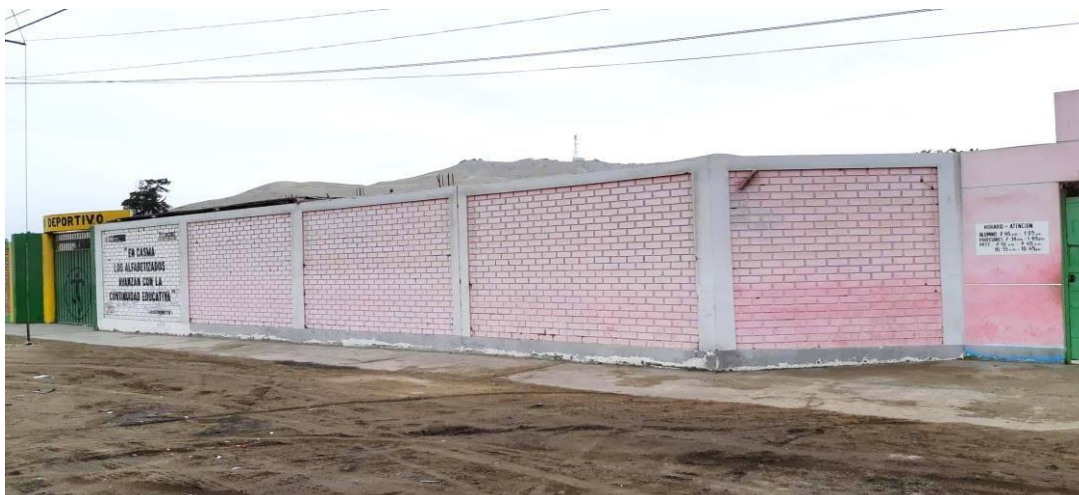
IMAGEN N° - 74: Estado de Cerco Perimétrico de la I.E. JOSÉ OLAYA
