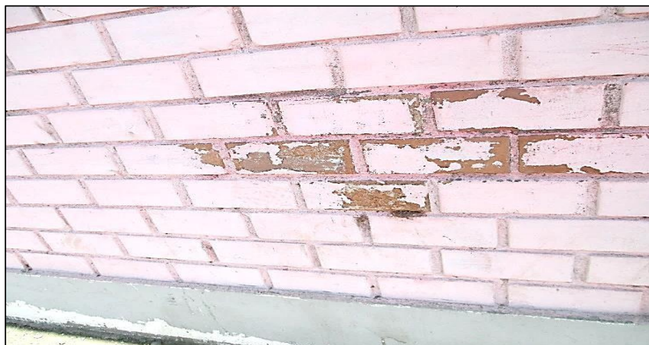
IMAGEN N° - 75: Estado de Cerco Perimétrico de la I.E. JOSÉ OLAYA
