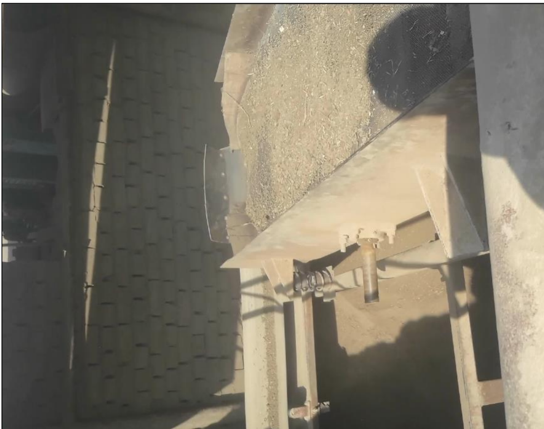
Figura 81. Zaranda dentro del silo.
